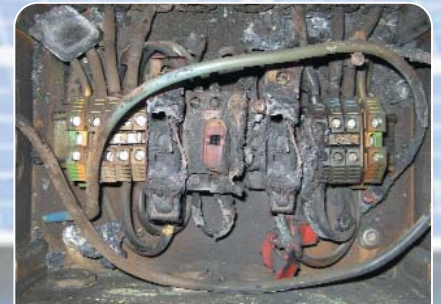
Dstrucción del dispositivo de protección, debido a la aplicación de soluciones de alterna en instalaciones de continua
